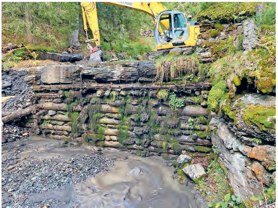
Schadensbild mit ausgeschwemmten Steinen
